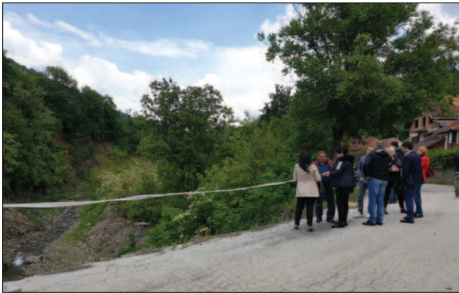
Набујала Гледићка река оштетила путеве па хитно треба поправити асфалт
